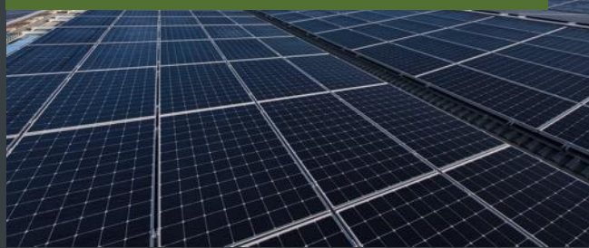
Fotovoltaico tetto e parete DC Bergamo
